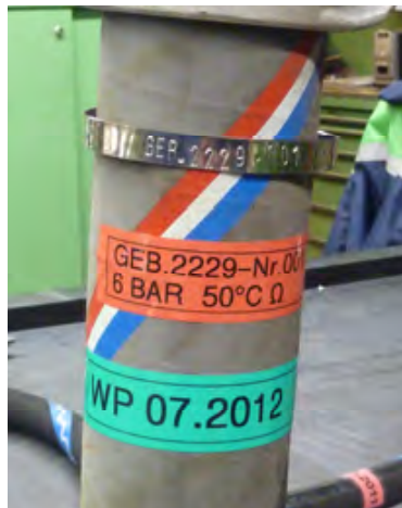
Abbildung 18: Beispiel einer gekennzeichneten Schlauchleitung
